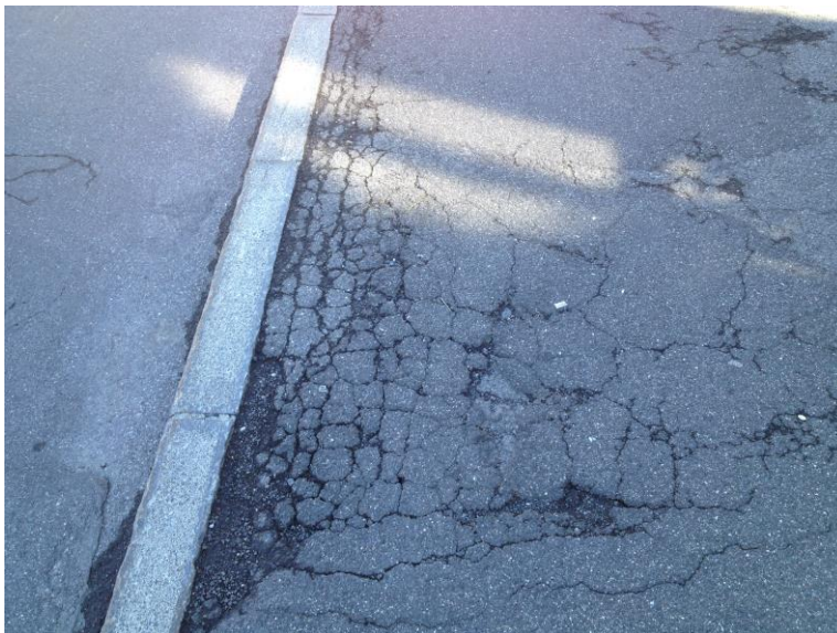
Abbildung 1: Belagsschäden Trottoir / Fahrbahn
