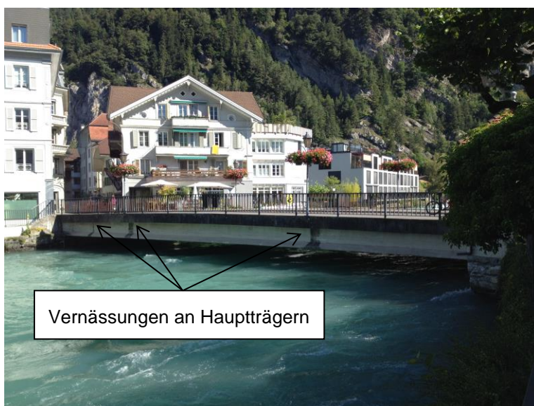
Abbildung 3: Spuren von Vernässungen auf den Brückenträgern
