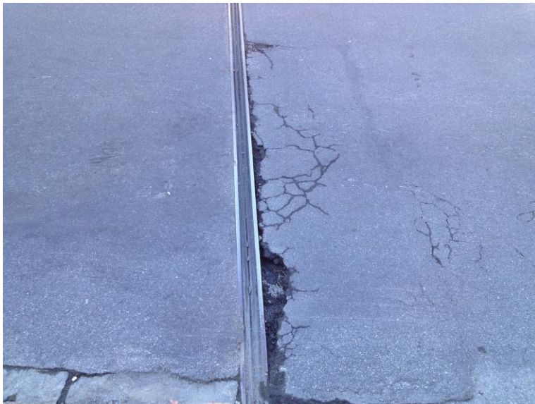
Abbildung 2: Fahrbahnübergang Seite Interlaken
