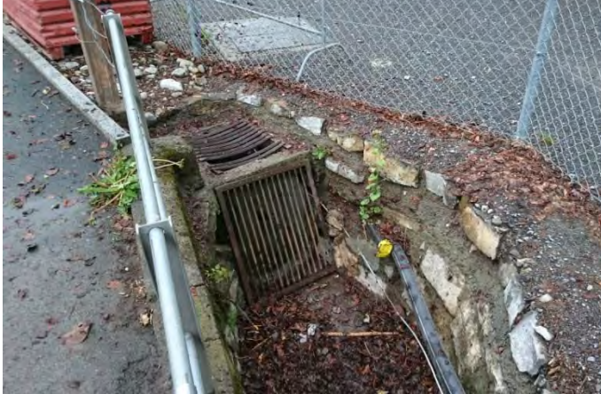
Abbildung 15 Bacheinlauf im Bereich Veloparkplätze Talstation Harderbahn
