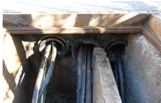
Abbildung 13 Einblick in Elektroschacht auf Trottoir 3 PE-Schutzrohre inkl. Leitungen
