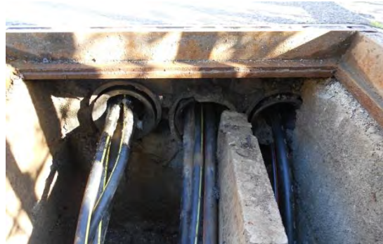
Abbildung 10 Einblick in Elektroschacht auf Trottoir 3 PE-Schutzrohre inkl. Leitungen
