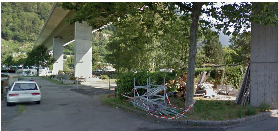
Abb. 2 Standort Goldswilviadukt, Blick von der Kammstrasse Richtung Aare. (Quelle: Google Street View)
